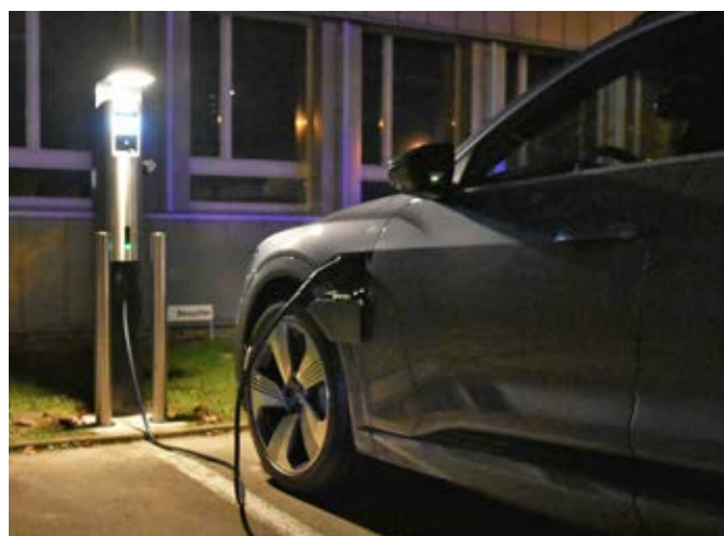
Ladestation und Beleuchtungspoller Elektra mit automatischer Lichteinschaltung
