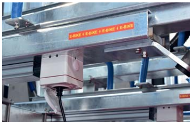
Station de recharge pour E-bike sous les rails coulissants
